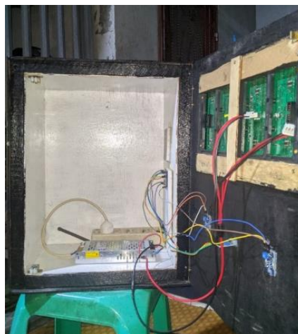
Gambar 2. Hardware Elektrik Sistem Kontrol
